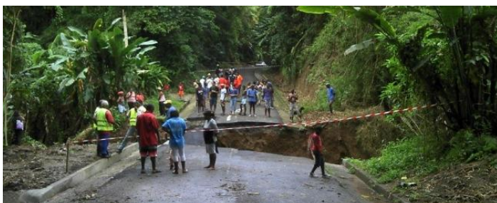
Inondations mai 2013 Affaissement de la chaussée RD10 à Grand-Rivière
