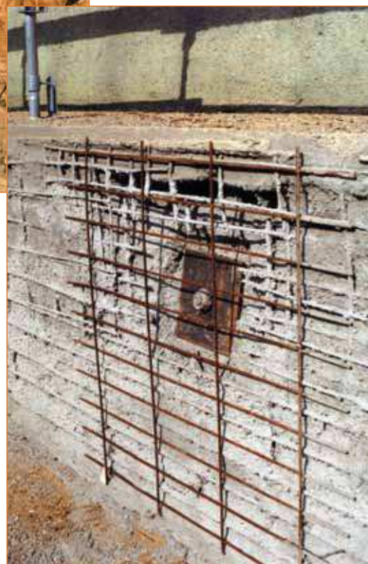
FIGURE 8 - Détail d'une tête de clou, cas des barres en acier à haute adhérence pour béton armé.
