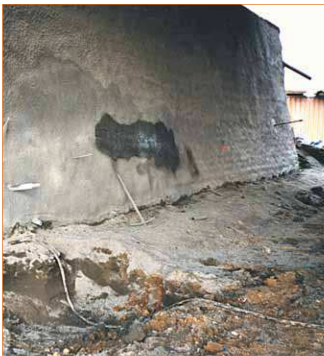
FIGURE 14 - Défaut de drainage.
